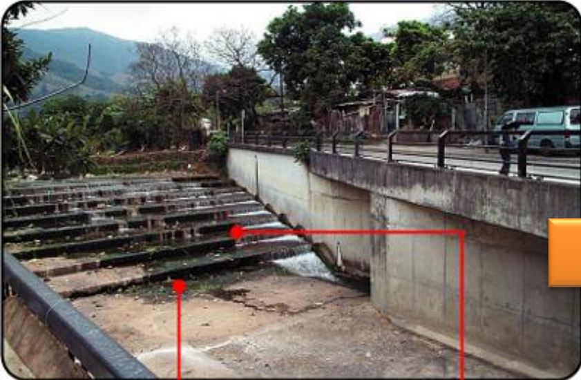
接合處及孔眼有滲漏
