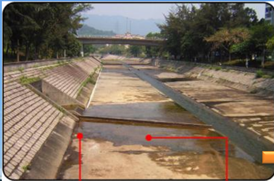
接合處有滲漏
